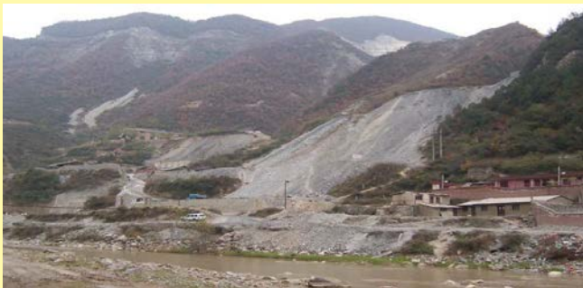
成县厂坝铅锌矿曾发生坍塌的弃渣体
