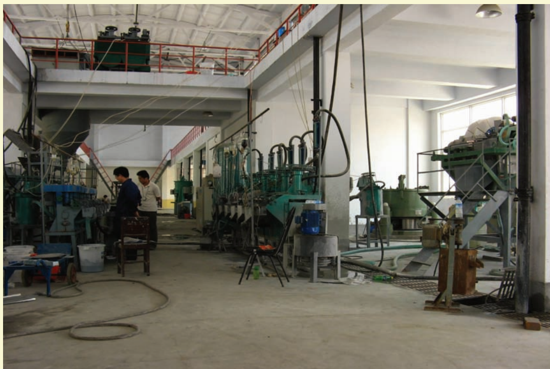
图 6-8 内蒙古 801 稀有多金属矿工艺技术研究扩大连续试验车间
