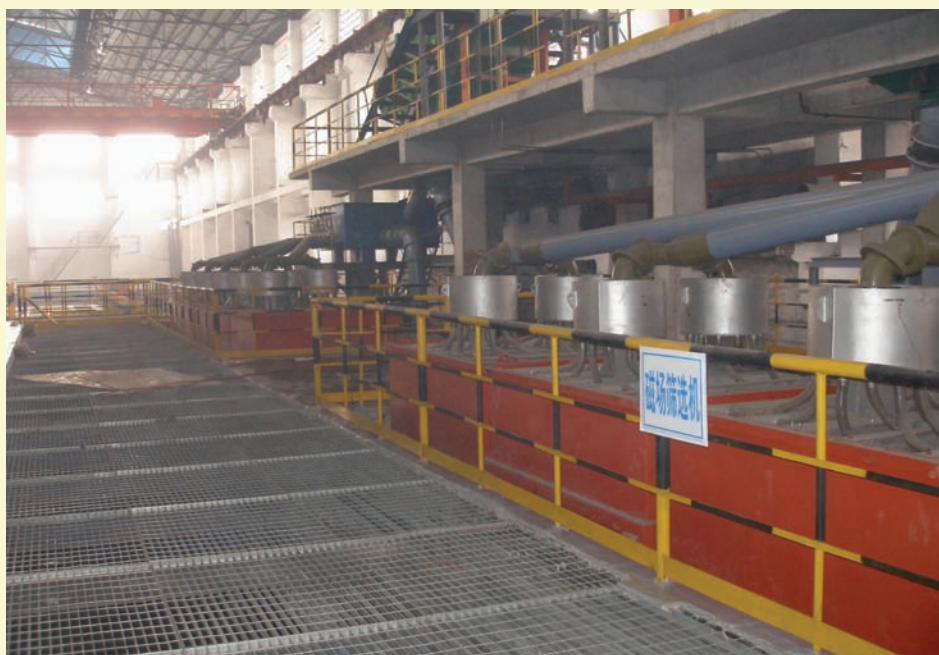
图 6-1 磁筛--武钢集团大冶铁矿选矿厂大量应用
