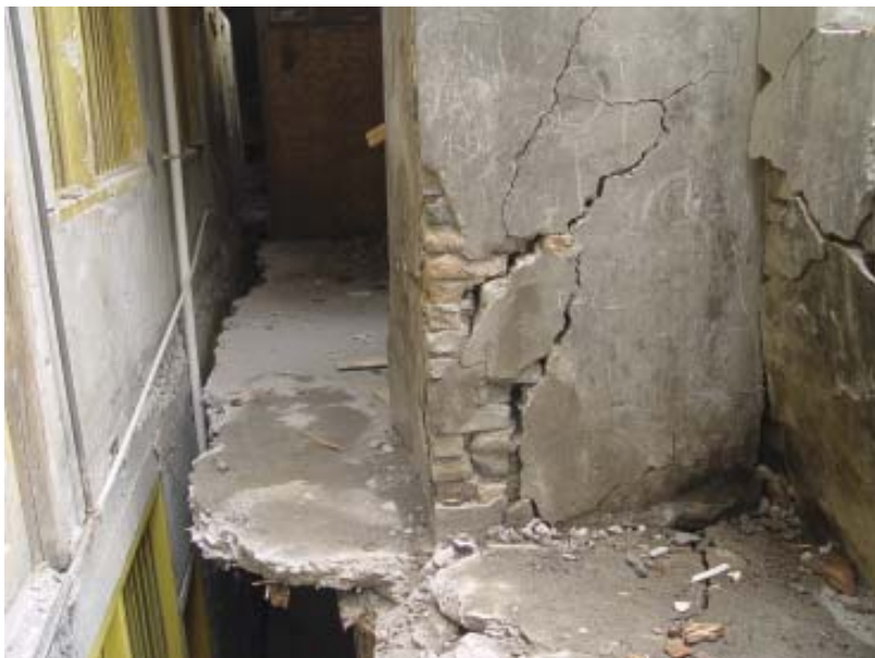
滑坡前缘挤压导致建筑物错裂（四川丹巴，2005）
