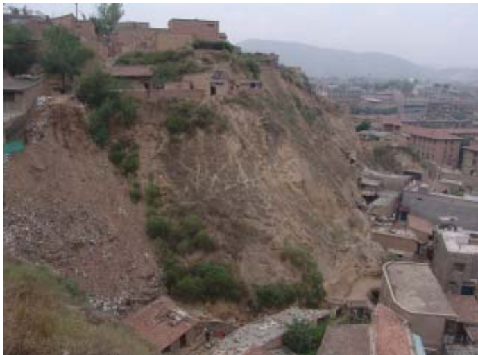
边坡未加支护，垃圾随意堆放沟中，存在滑坡泥石流隐患 (甘肃兰州，2006)
