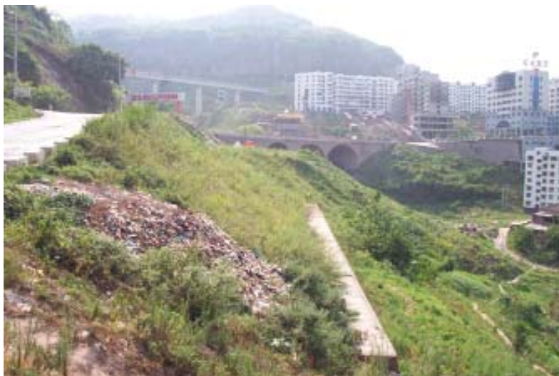
在滑坡后部随意排放渣石弃土，使滑坡稳定性明显降低，危及下方居民安全（重庆万州关塘口滑坡，2002）
