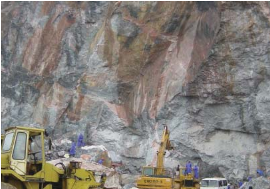
岩体被裂缝切割成不稳定楔形体。随意采石诱发崩塌，28人死亡（江西乐平，2001）
