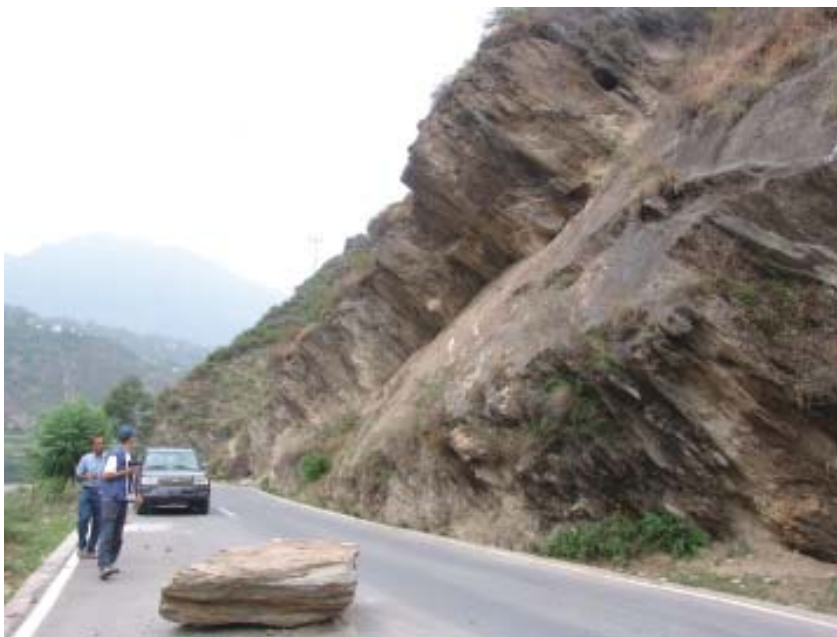
斜坡岩层中裂缝发育，易形成滑坡、崩塌（四川丹巴，2006）
