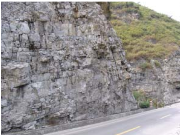
岩体下部出现压裂带易发生崩塌和落石 (重庆武隆, 2006)
