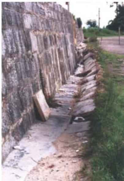
滑坡前缘挡墙地面出现鼓胀反翘 (云南保山, 2000)
