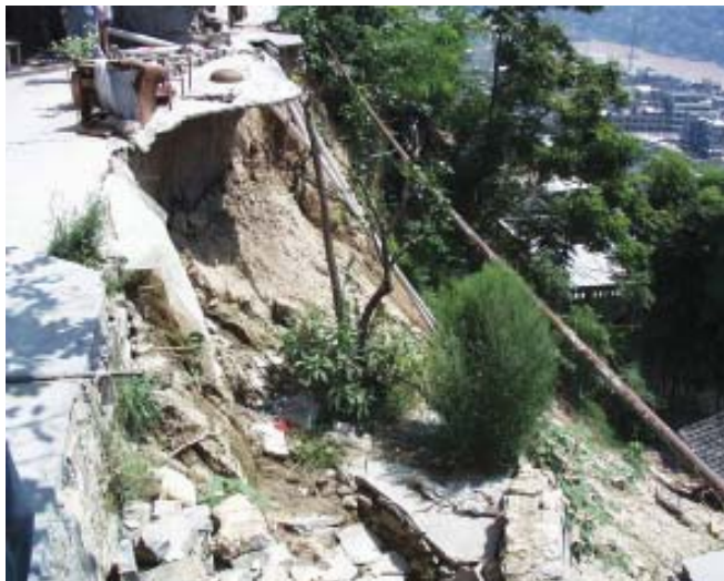
堡坎未坐落在稳定地基上，局部滑塌（重庆巫山，1998）
