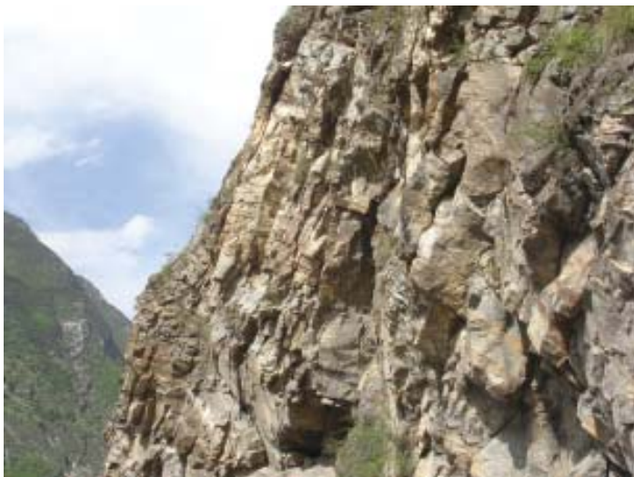
岷江上游峡谷岩体被多组裂隙切割，破碎，极易发生崩塌、滑坡（2006）
