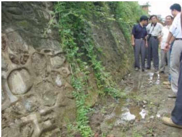
滑坡前缘重力挡墙下地基冒水，阻滑力差，易于破坏（陕西岚皋，2000）
