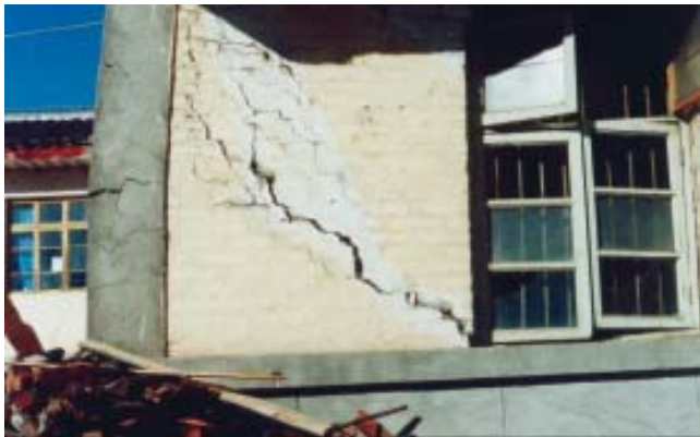
滑坡中部变形导致建筑物鼓胀错裂（四川木里，1999）
