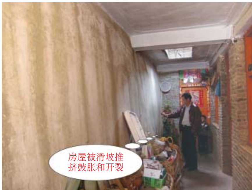
位于滑坡前缘的房屋被推挤变形，应纳入汛期防灾预案（云南德钦，2006）
