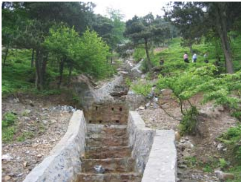
江西庐山泥石流防护工程（2002）
