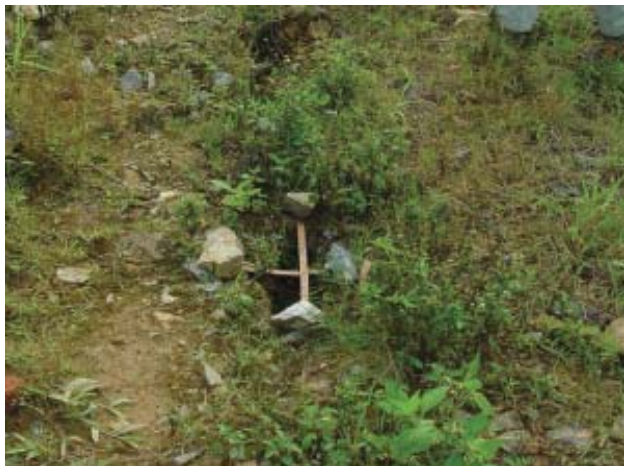
在裂缝两侧设置标尺，可以简易量测滑坡变形量
