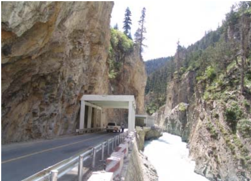
川藏公路线公路边坡岩体破碎，极易发生崩塌（2006）
