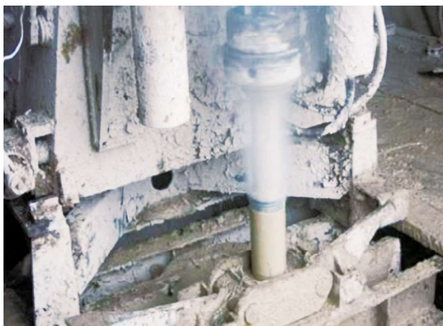
QK-6井发现高压天然气泄漏
