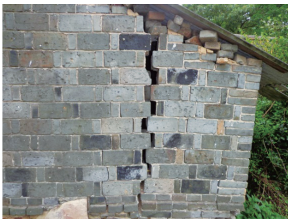
曲塘镇新居上村煤矿开采的地面沉降导致房屋变形
