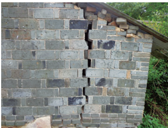
曲江镇新居上村煤矿开采的地面沉降导致房屋变形
